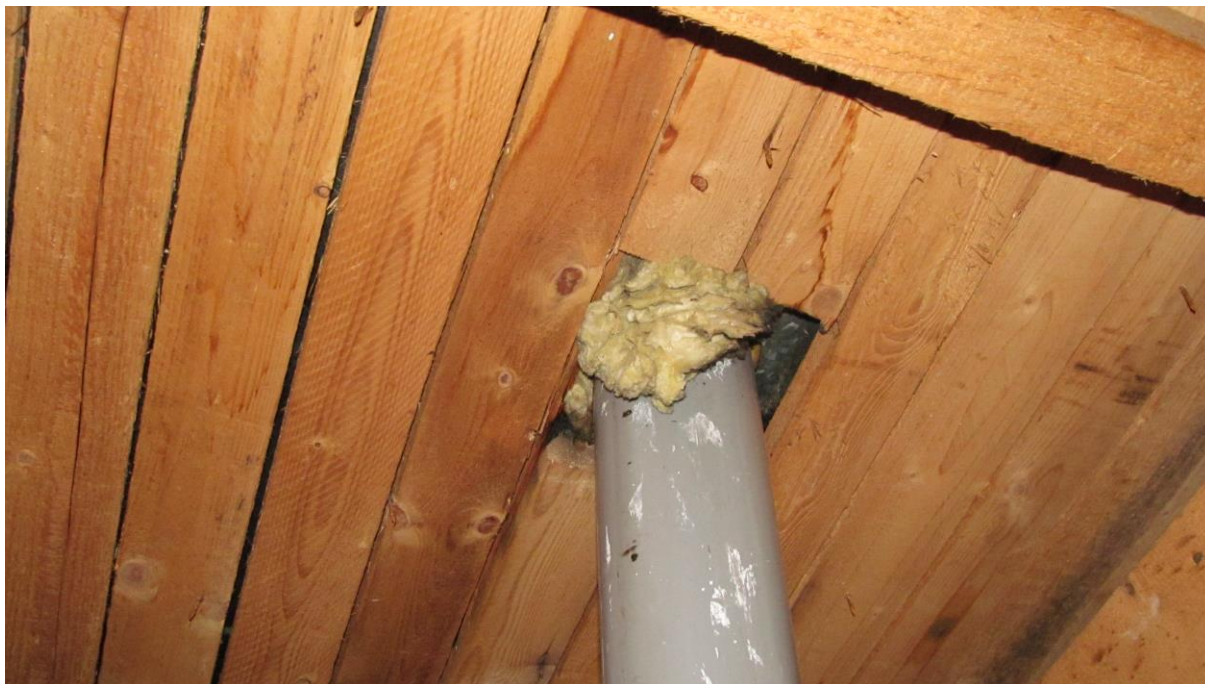
Detail prestupu 2 na povale
