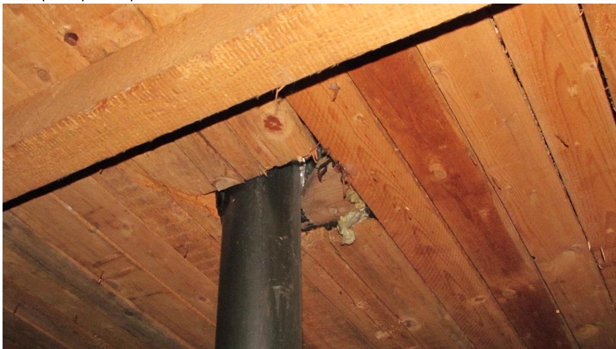
Detail prestupu 1 na povale
